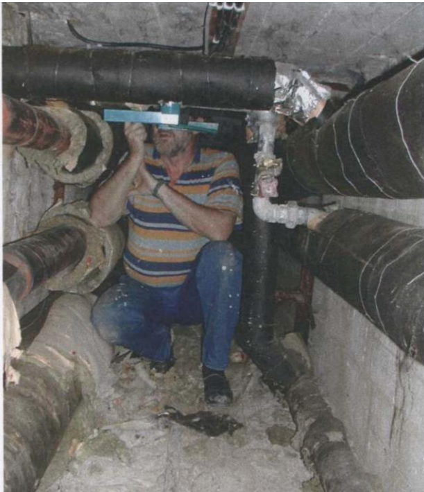
Varmekanal langs Mortenstrupvej
