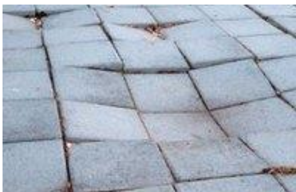
Pludseligt opståede lunger i belægning
